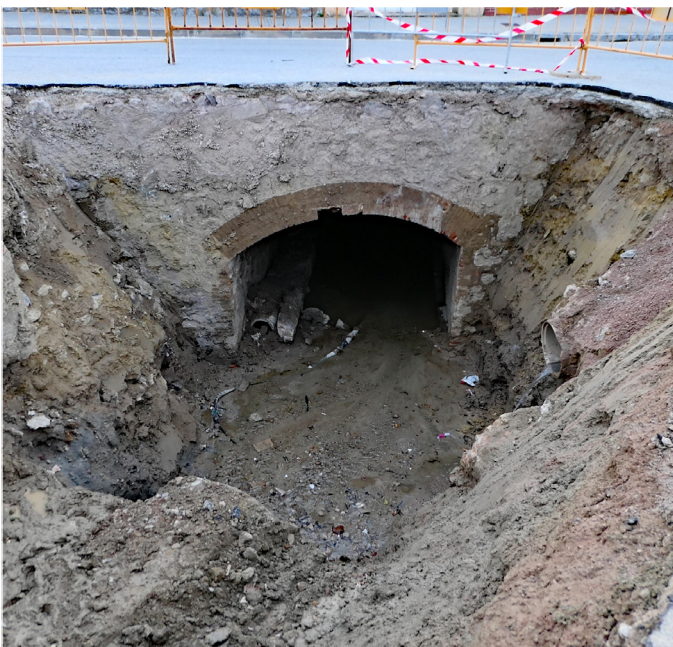
Zona de la canalització quan es va esfondrar
