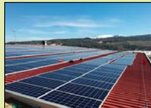
Plaques solars a la piscina coberta. Maig de 2018
