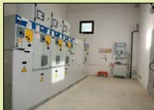
Estació transformadora de Banyeres
